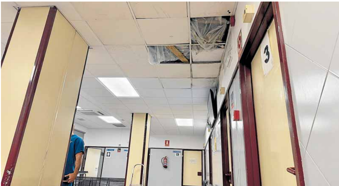
Estado del techo de la sala de espera donde se filtran las aguas residuales. LP
